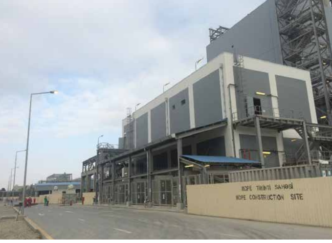
YSPE zavodu: Elektrik yarımstansiyası. Kabellerin çekilmesi ve kabel ucuqlarının /klemmaların taxılması başa çatmışdır
