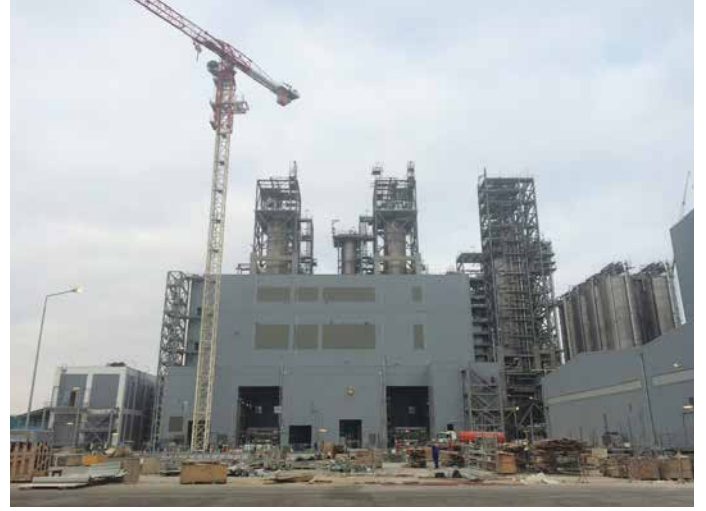
YSPE zavodu: Ekstruziya qurğusu. Boru sistemlərinin izolyasiya işləri başa çatmışdır. Qapıların quraşdırılması demək olar ki, başa çatmışdır.
