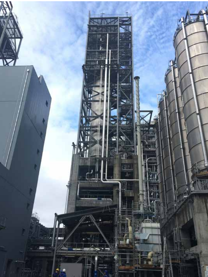
YSPE zavodu: Orqanoleptik qurğu/Tullantı sularının təmizlənməsi qurğusu. Natamam işlərin yerinə yetirilməsi davam etmişdir
