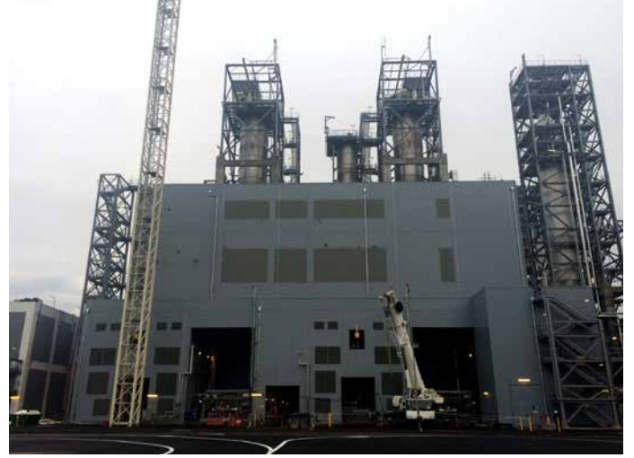
YSPE zavodu: Ekstruziya qurğusu. Natamam işlərin yerinə yetirilməsi davam etmişdir
