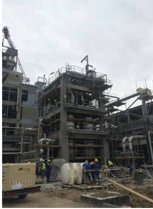
YSPE zavodu: Etilenin işlənməsi. E-1423, D-1901 və E-1901 bölmələrində avadanlığın izolyasiyası başa çatmışdır
