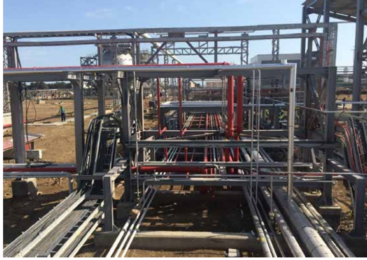
PP zavodu/ Mř ve ŰT: Birleřdirici boru estakadaları. ICPR 800, 801, 802, 803, 804, 807, 809, 810, 819 sayılı natamam iřler siyahısındaki iřlerin bařa řatdırılması davam etmiřdir
