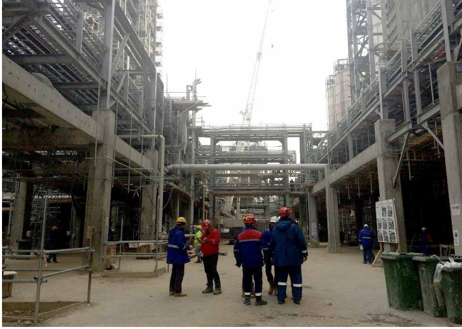
YSPE zavodu: Polimerləşdirmə qurğusunun boru estakadası.
