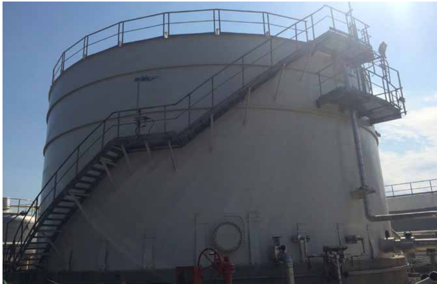
PP zavodu/ MŞ və ÜT: Xam su çəni. Natamam işlər siyahısındakı işlərin başa çatdırılması davam etmişdir
