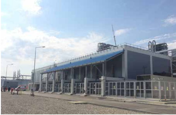
PP zavodu/ MŞ və ÜT: Elektrik yarımstansiyası. Natamam işlər siyahısındakı işlərin başa çatdırılması davam etmişdir
