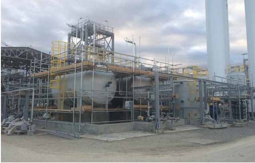
PP zavodu/ MŞ və ÜT: Hava/Yüksək təzyiqli azot kondensatı kompressor stansiyasının rezervuar və nasos təsərrüfatı. Buraxılış-sazlama işləri davam edir
