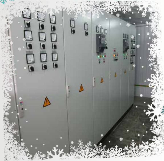
Azot qurğusuna elektrik enerjisi verildi
