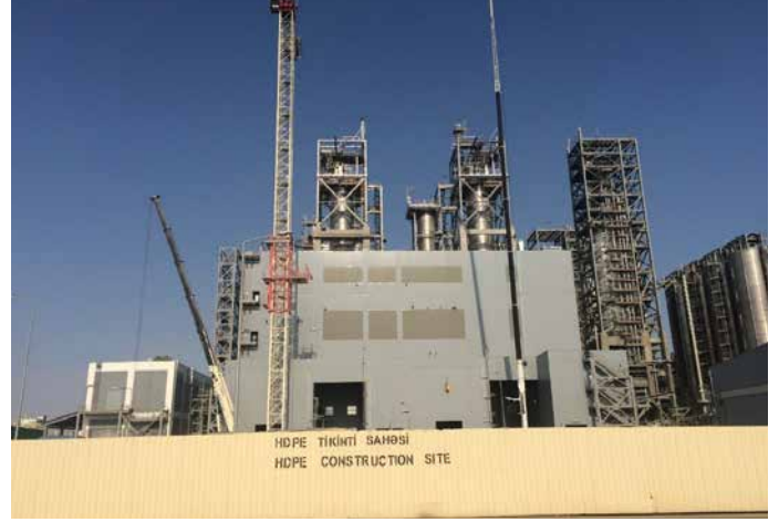
YSPE zavodu: Ekstruziya qurğusu. Dam örtüyünün döşənməsi başa çatmışdır. Sendviç panellərin quraşdırılması esasen başa çatmışdır. Boru sistemlərinin quraşdırılması davam etmişdir. İVHK üçün elektrik kablərinin çəkilməsi davam etmişdir
