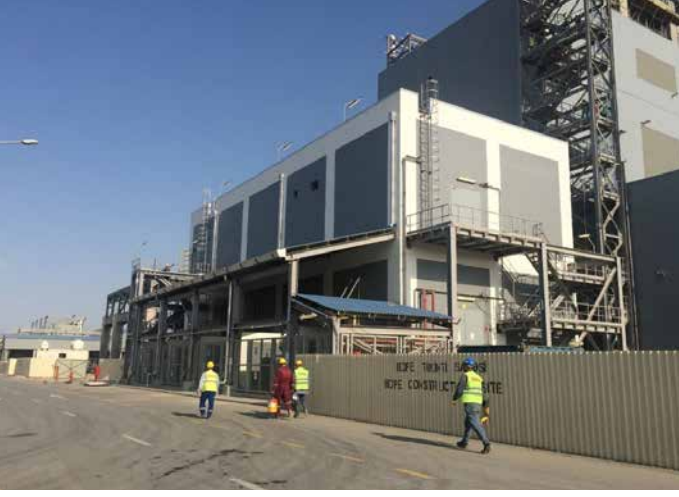
YSPE zavodu: Elektrik yarımstansiyası. Kabellərin çəkilməsi və kabel ucluqlarının / klemmaların taxılması başa çatmışdır
