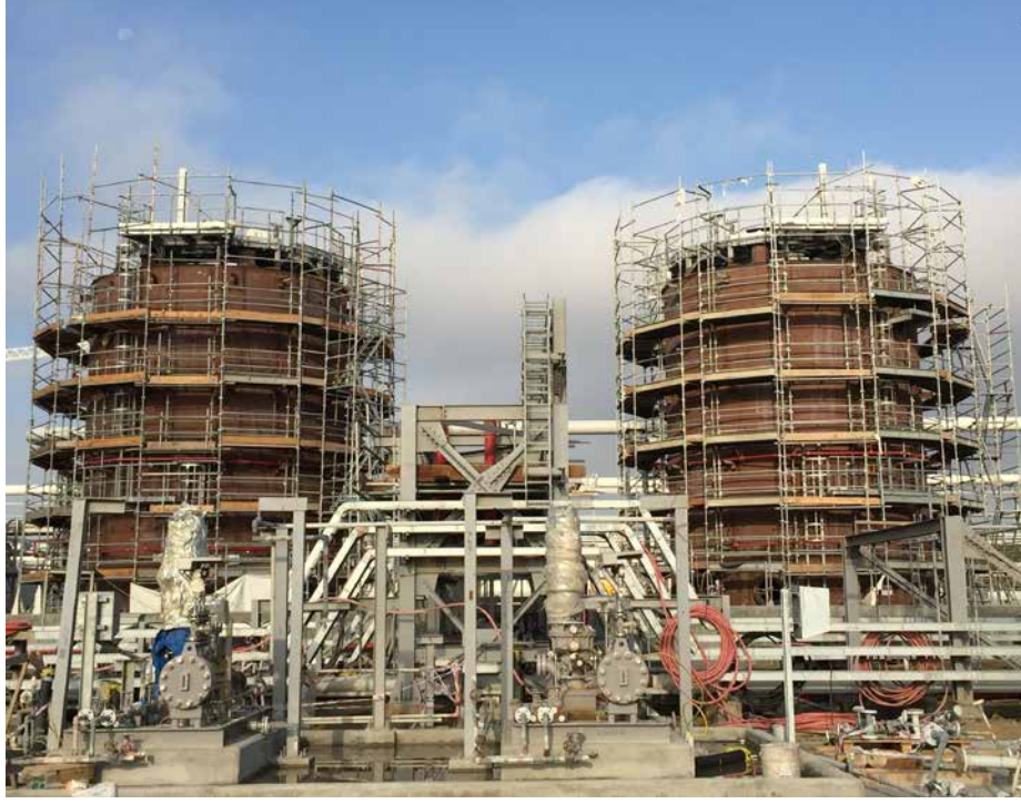
PP zavodu/ MŞ və ÜT: Heksen rezervuarı. Rezervuarın montajı davam etmişdir. Boruçəkmə işləri davam etmişdir
