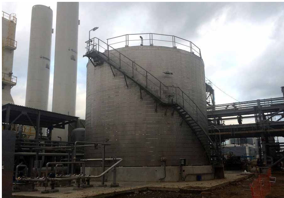
PP zavodu/ MŞ və ÜT: Mineralsızlaşdırılmış su çəni. Buraxılış-sazlama işləri davam etmişdir
