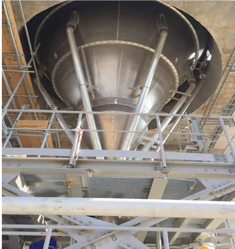
PP zavodu/MŞ və ÜT: Homogenləşdirmə/Qarışdırma silosu. Nasosların və avadanlığın sazlanması və boruların vahid xətt üzrə mərkəzləşdirilməsi davam edir. NÖC quraşdırılması başlamışdır
