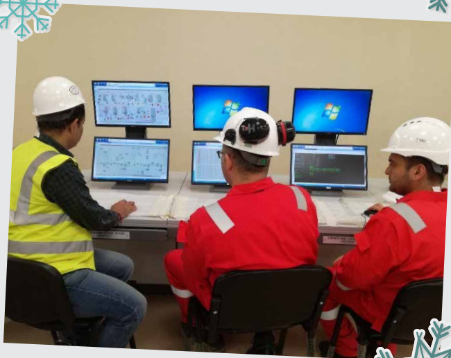
İdarəetmə otağının monitorları canlandı
